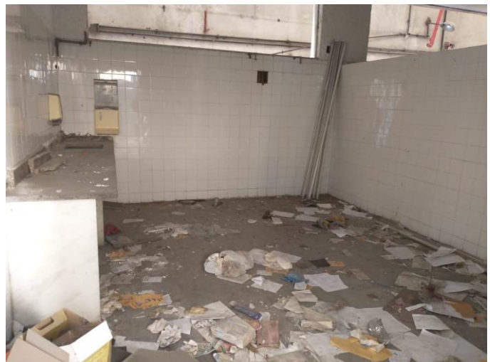
Fig 03: Estado atual das antigas salas de aula/estudo do laboratório anatômico principal.
