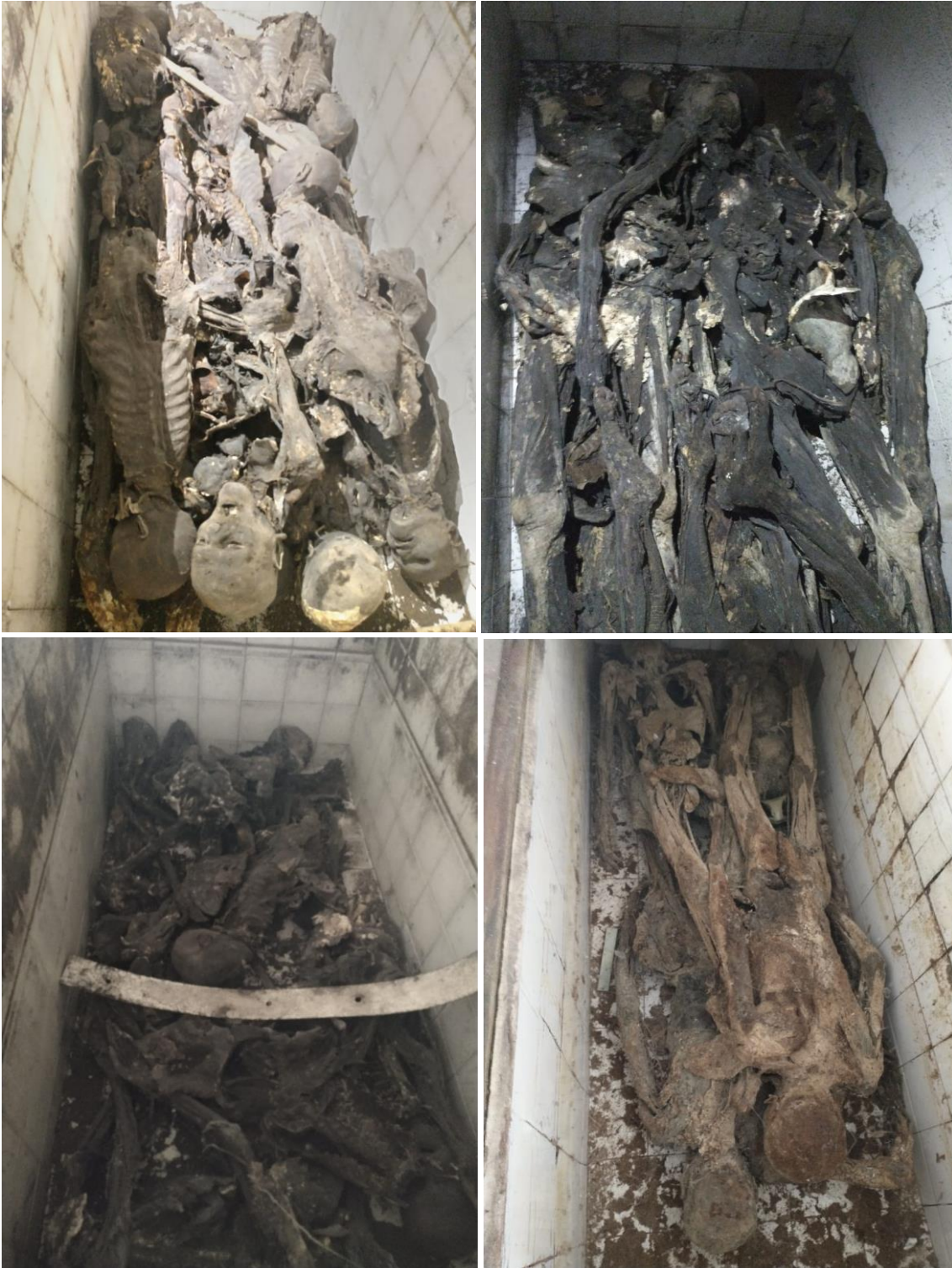
Fig 06: Estado atual de material cadavérico encontrado dentro de algumas cubas do laboratório anatômico principal e do laboratório anatômico do prédio anexo – foram encontrados partes de corpos, membros e cadáveres em estado de degradação e mumificação, não sendo mais úteis para o estudo da anatomia. Sendo assim, as mesmas permaneceram no local onde foram encontradas.
