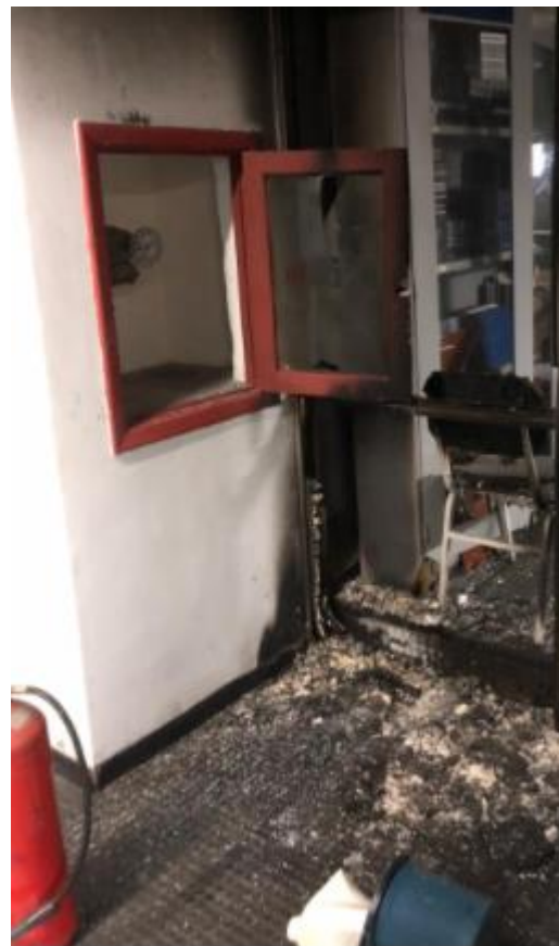
Foto 2 - Pequeno foco de incêndio
