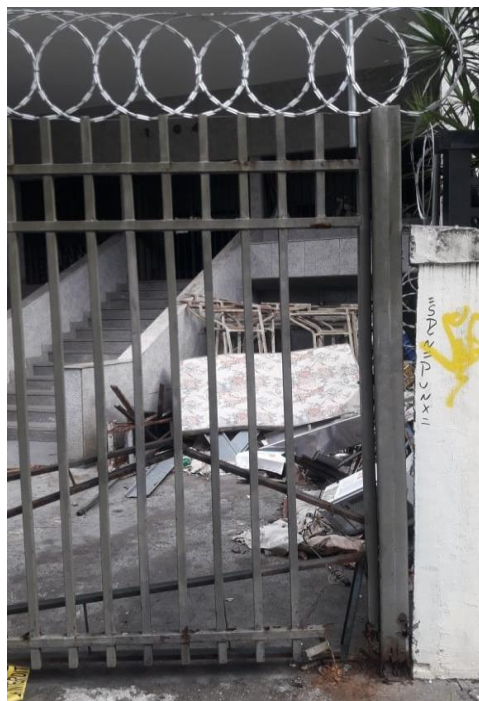
Figura 4: Barra de ferro retirada no canto direito do portão
