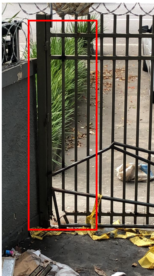
Figura 2: Barra de ferro recolocada no gradil externo do imóvel
